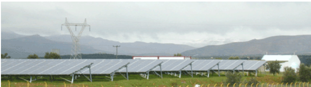
Ηλιακός σταθμός ηλεκτροπαραγωγής στην Κρήτη
