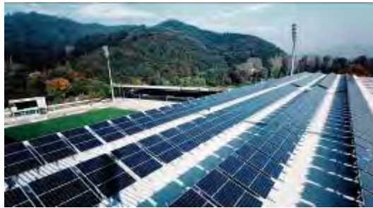
Ενσωμάτωση φωτοβολταϊκών σε γήπεδο ποδοσφαίρου
