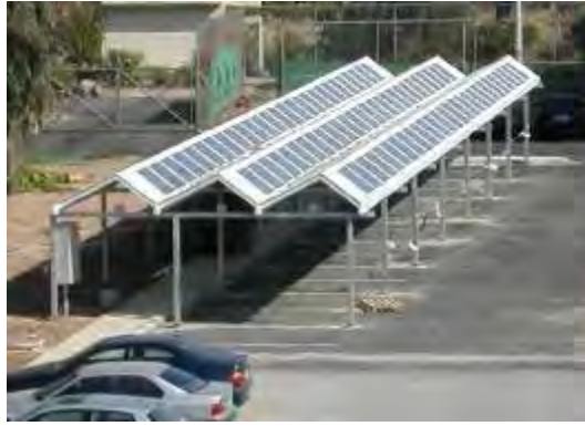
Εφαρμογή φωτοβολταϊκών σε χώρο στάθμευσης στο Μαρούσι
