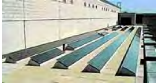
Εφαρμογή φωτοβολταϊκών σε τσράτσα κτιρίου
