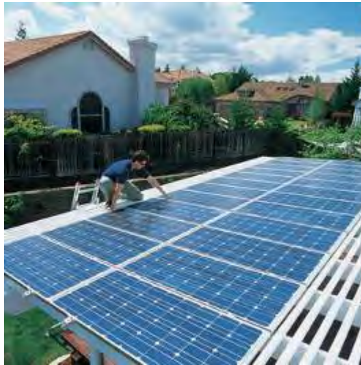
Εφαρμογή φωτοβολταϊκών σε σκέπαστρο
